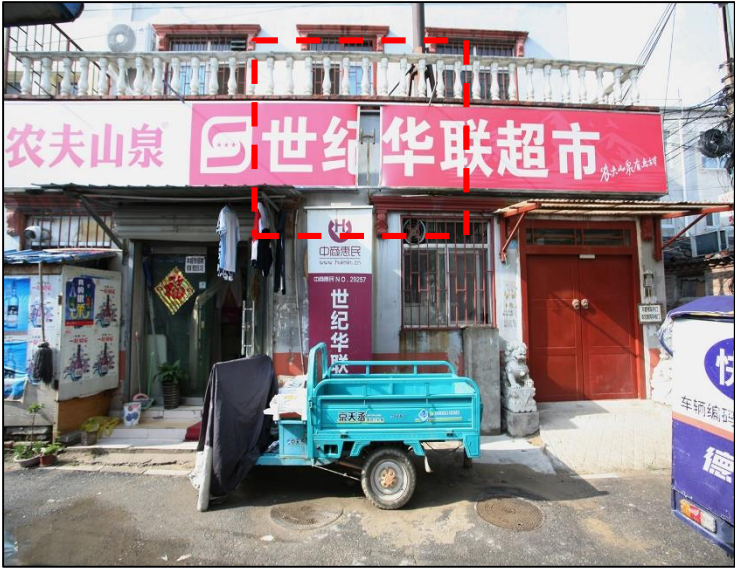
牌匾破损，设置于扶手存在安全隐患
