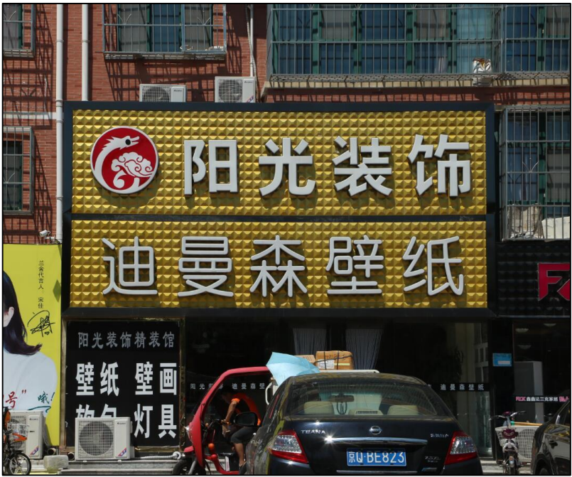
牌匾标识阻碍空调、进气窗通风
