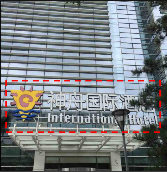
雨棚牌匾标识超出雨棚宽度
