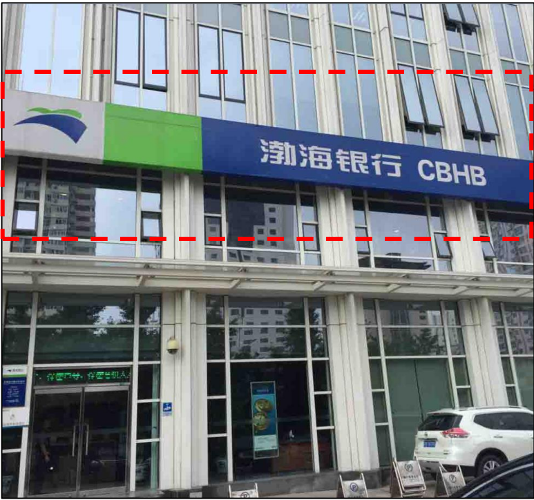
牌匾标识覆盖建筑线脚
